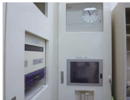
エネルギー使用量が確認できるメーター
