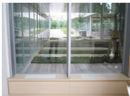
室内のクールチューブ（噴出し）
