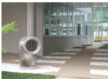
室外のクールチューブ（吸込み）
